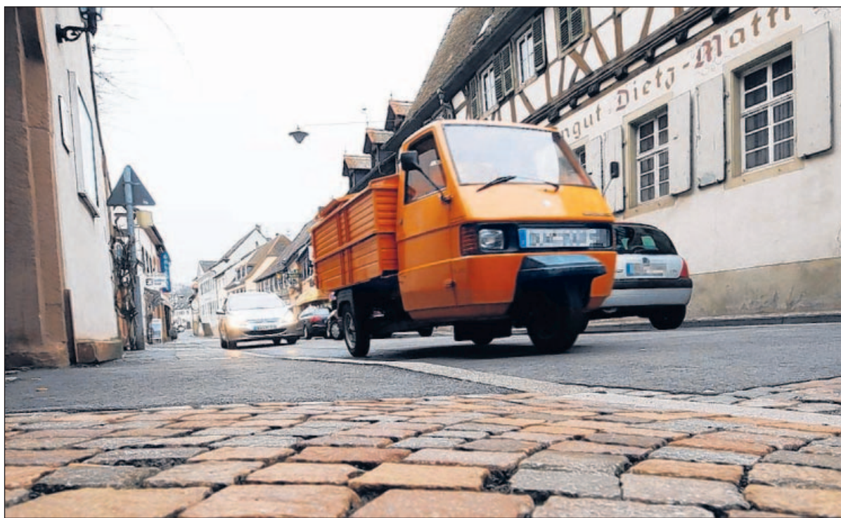
Im Zentrum von Deidesheim bei Marktplatz und Rathaus liegt schon das neue Pflaster, nun kommen als nächstes die Gehwege in südlicher Richtung dran.
